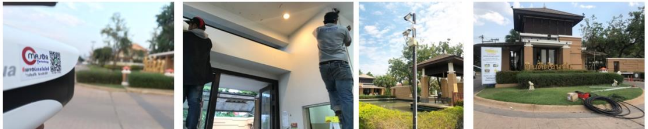
ติดตั้งระบบกล้องวงจรปิด โครงการหมู่บ้านชลดา จังหวัดขอนแก่น
